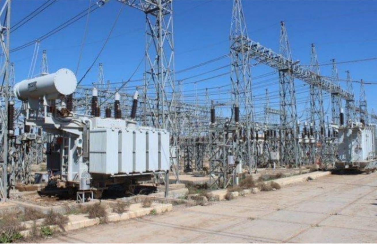
إحدى المحطات الكهربائية
