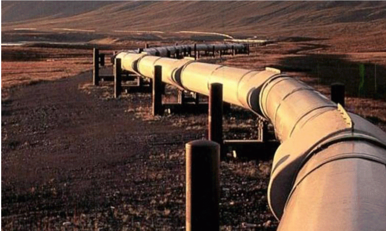
أنابيب نقل النفط
