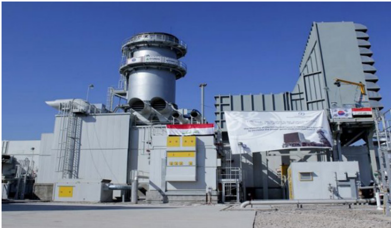
محطة لتزويد الكهرباء في العاصمة
