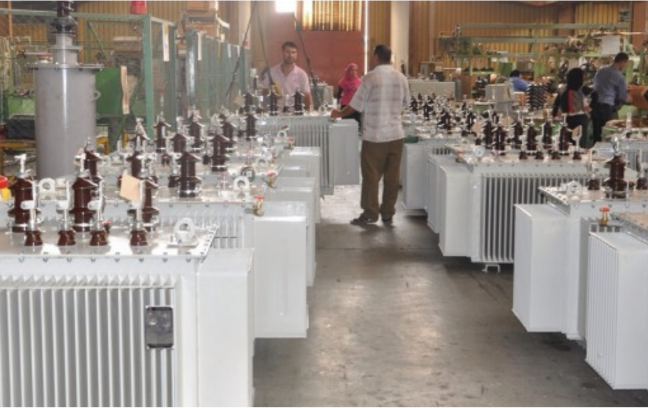
إحدى المحطات الكهربائية
