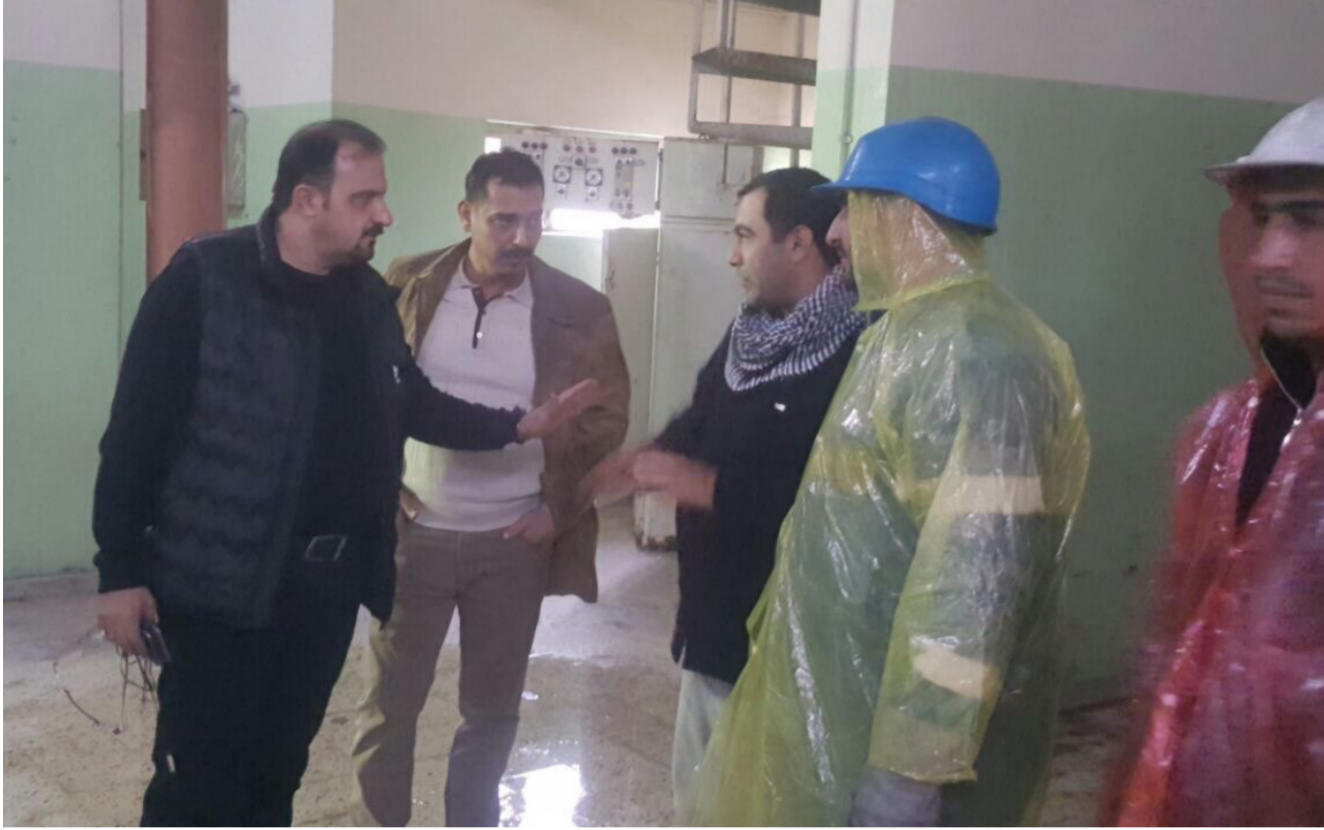
مدير كهرباء الكرخ يشرف على إدامة مضخات تصريف مياه الأمطار
