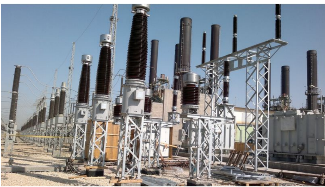
إحدى محطات الطاقة الكهربائية
